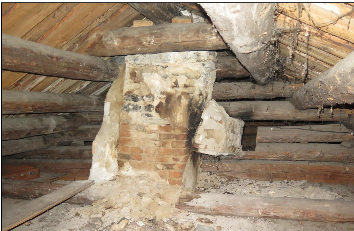
Före åtgärder. Murstocken på vinden med rökanalen till höger från övre kammarens rörspis. Vid glipan och otätheten mellan murstocken och rökanalen syns sot. Foto Lars Bergström 2021-05-17.
